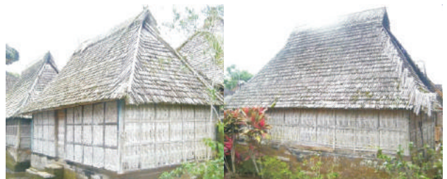
Gambar 24. Tidak Adanya Ventilasi Pada Rumah Tinggal Desa Penglipuran (Sumber: Dokumentasi, 2012)
